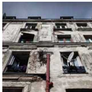
Copropriété dégradée en Seine-Saint-Denis.
